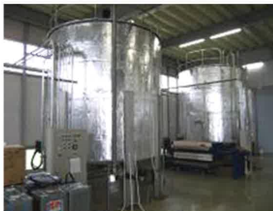
プラント内一部
